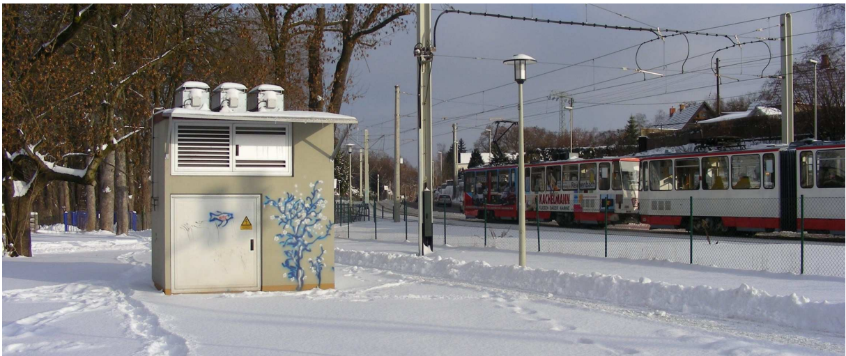
Bild 1: Energiespeicherwerk in Zwickau, Planitzer Straße mit einem Schwungradenergiespeicher
